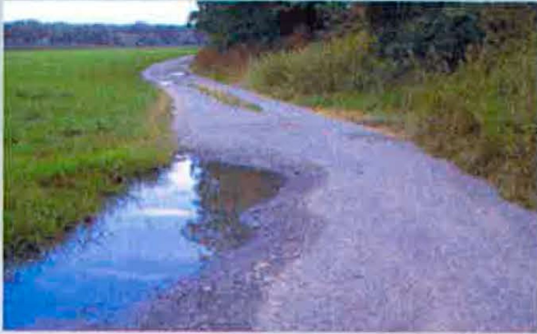
Vorher Wassergebundene Fahrbahndecke mit Beschädigungen
